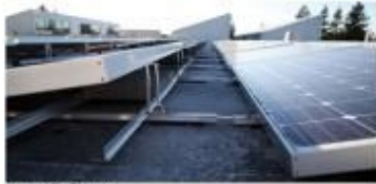
Low profile PV array
