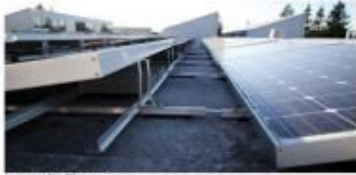
Low profile PV array
